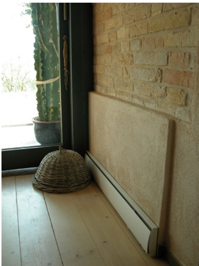
Riscaldamento a battiscopa (Foto: Studio Tecnico Ambiente)
