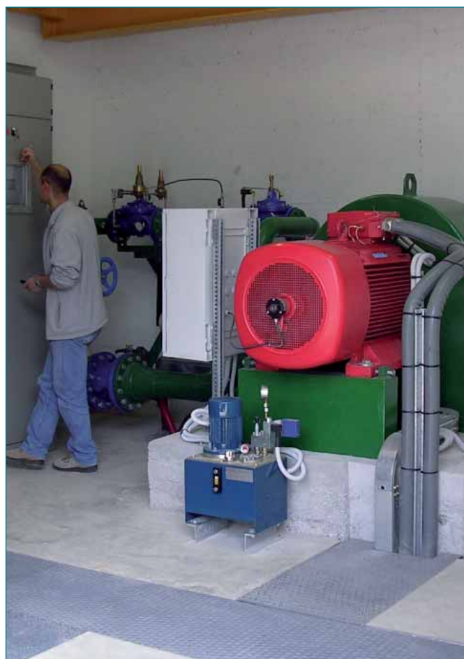
Impianto micro-idroelettrico. Fonte Mecamidi Sasso
