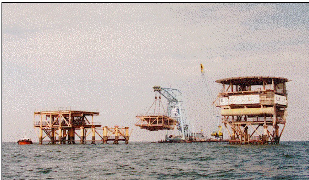
Figura 3-46: sollevamento di un deck
